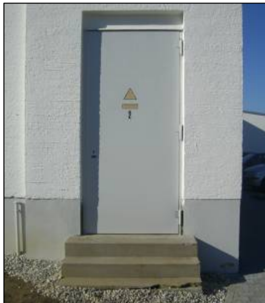
Zum Beispiel Türen in Brandwänden von Hühnerhallen T 90.
