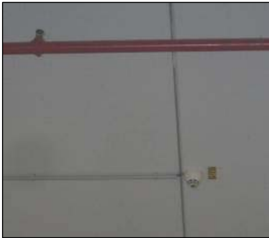
Eingebauter Rauchmelder in einem Industriebetrieb. Im Vordergrund ist die Rohrleitung sowie ein Sprinklerkopf der fest eingebauten Feuerlöscheinrichtung zu sehen.
